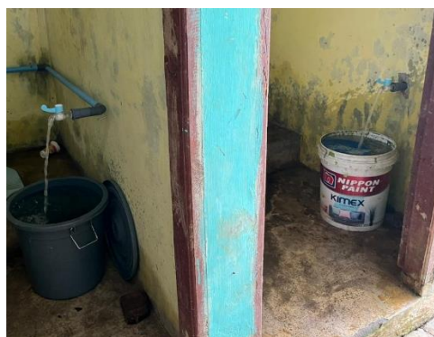
Gambar 10. Penyaluran air di toilet SMP Eka Nusantara
