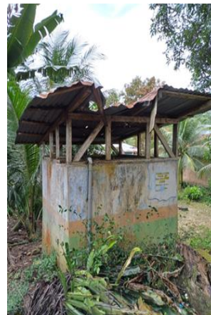
Gambar 4. Bak penampung air
