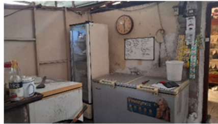
Gambar 4. 1 Chiller Penyimpanan Bahan
